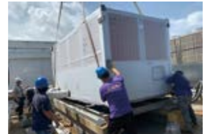
空調用熱源機器の更新
