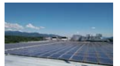
太陽光発電システム アルバック成膜株式会社
