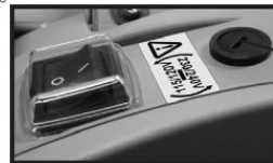
電圧切替スイッチ
