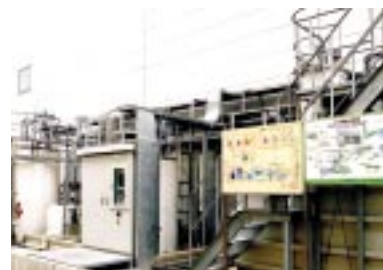
フッ素排水処理設備
