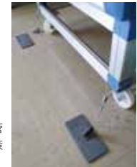
地震直後、化学物質保管庫の耐震対策の器具が破損
