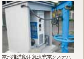
電池推進船用急速充電システム
